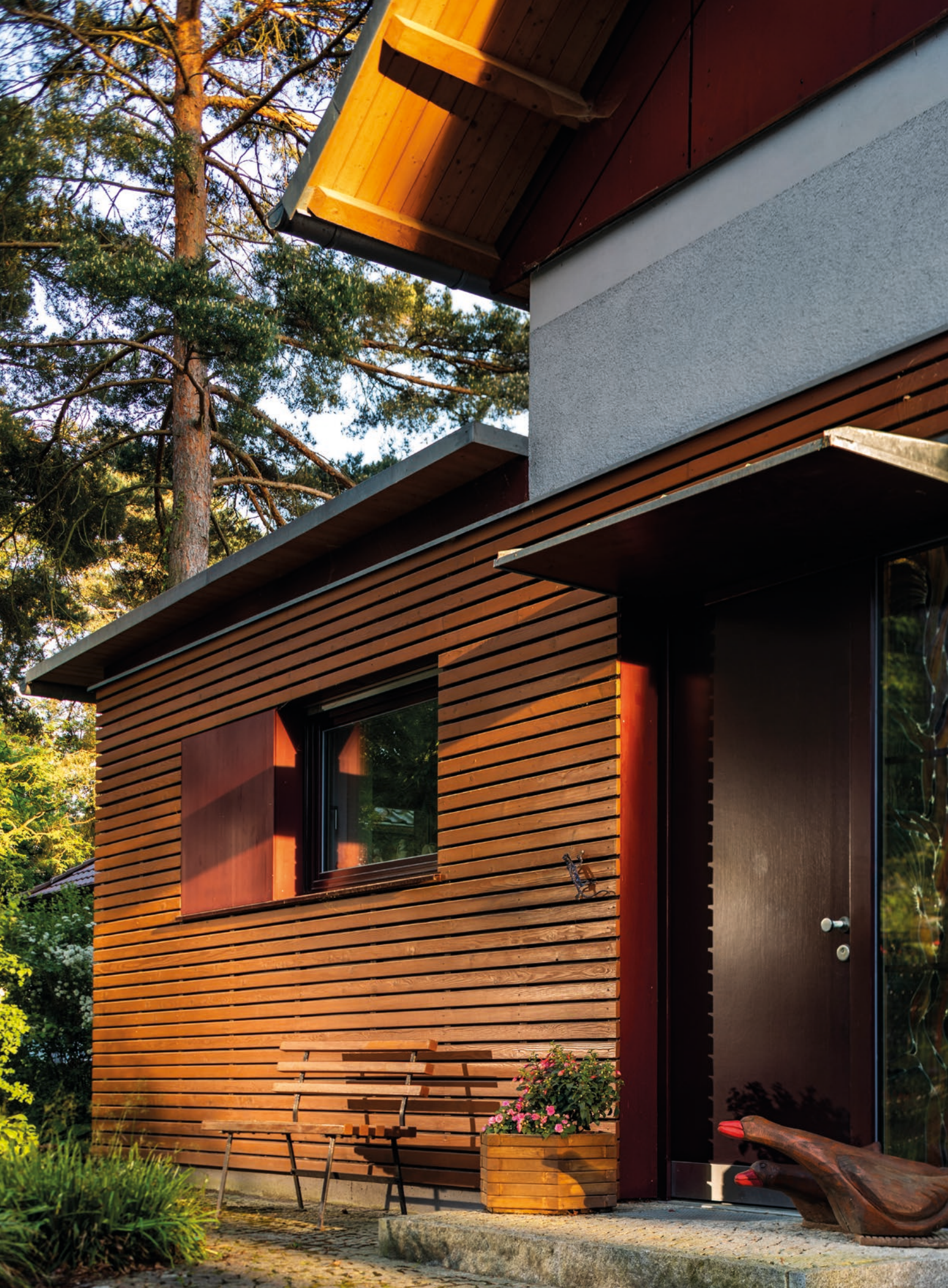
Rautenleiste sib. Lärche, endbehandelt mit Osmo Holzschutz Öl-Lasur 728 Zeder
