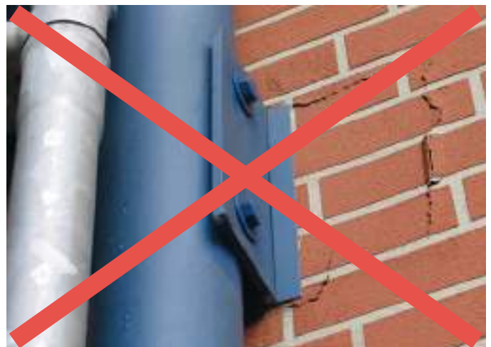
Folgeschäden eines falschen Wandanschlusses
